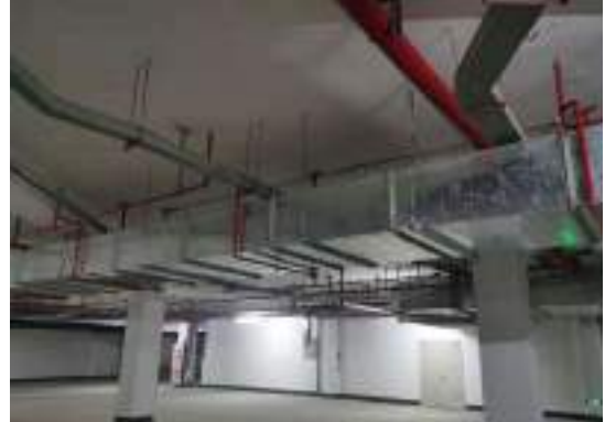
地下车库排风系统管道
