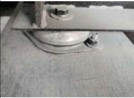
柴油发电机房减震
