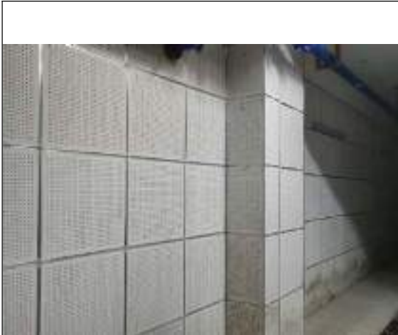
风机房隔声墙
