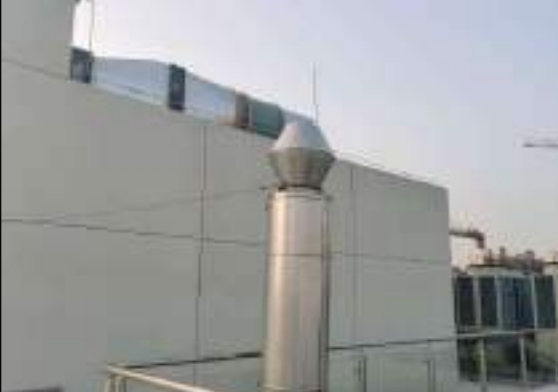
柴油发电机房烟气排放口
